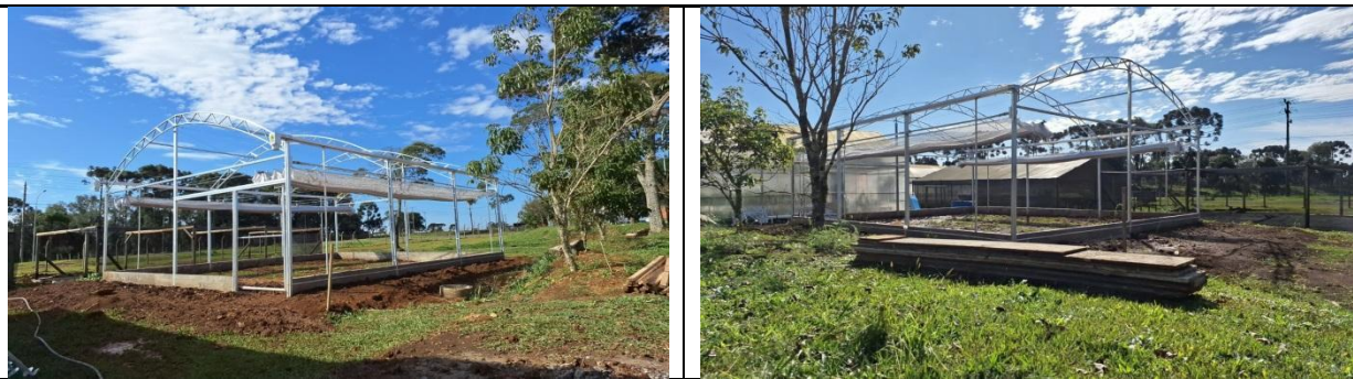
Figura– Início da instalação dos viveiros do projeto REFORMA no Campus Curitibanos da UFSC.
